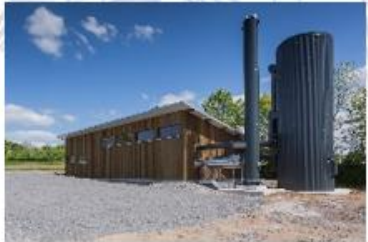
Wärmepumpen + Erdgas-BHKW + Wärmespeicher
