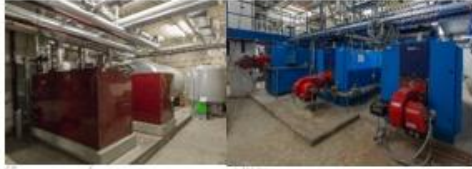
Erdgas-BHKW + Wärmespeicher + Gas/Öl-Kessel
